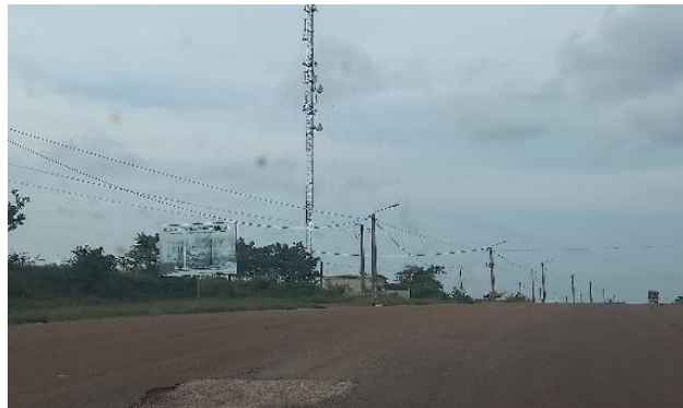
Photo 2 : Vue d'une antenne réseau-Buyo
